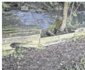
Ein Zaun an der Breitsach wurde eingetreten. Fotos: Stadtgemeinde Ried
