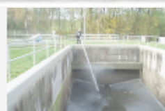
Senkgrube und Pumpstation
