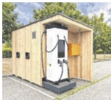
LumoPower Wood ist eine semimobile Batteriestation in Holzbauweise für temporäre Verbraucher. Foto: Klaus/Sunlumo
