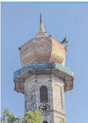
Sanierung Der Zwiebelturm der spätgotischen Pfarrkirche Burgkirchen wird in diesem Sommer aufwendig restauriert. Foto: Tips/Danter
