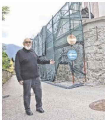
Pfarrkirche Sanierungen zur Sicherheit und zum Denkmalschutz fordern die Pfarre Ebensee finanziell. Seite 4 / Foto: Hörmandinger
