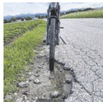
Gefährliches Schlagloch Foto: Hüttmeyer
