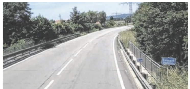
Dieser Abschnitt auf der B148 muss umfassend saniert werden.
