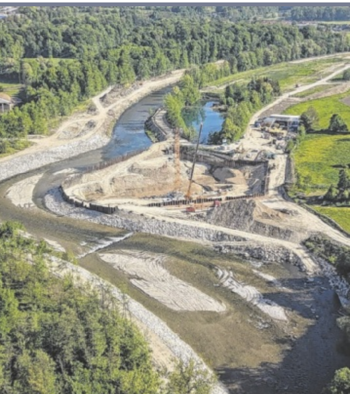
Kraftwerk An der Ager entsteht ein neues Wasserkraftwerk: Die Bauarbeiten kommen aktuell rasch voran. Baugrubenumschließung und Aushub sind bereits abgeschlossen, jetzt wurde der Kran aufgestellt. Derzeit laufen die Vorbereitungen für die Bodenplatte sowie erste Schalungsarbeiten an der Wehranlage. Foto: KKW
