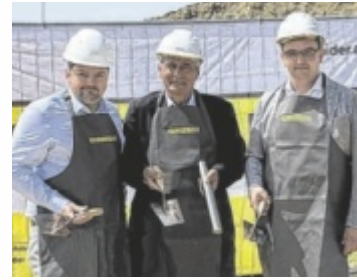
Grundsteinlegung, v. l.: Prokurist Thomas Haudum (NH OÖ), Landtagsabgeordneter Herwig Mahr und Bürgermeister Karl-Heinz Koll
