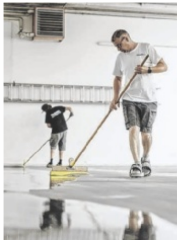
Garagenbeschichtungen schützen, sind pflegeleicht und langlebig. Foto: Floorex
