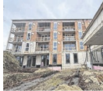
Die Wohnanlage Leumühle in Popping nimmt bereits Gestalt an. Foto: SHV Eferding
