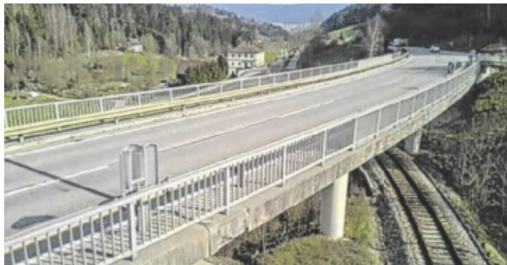
Die 1987 errichtete Bahnbrücke Lauss im Gemeindegebiet von Oeping braucht eine Generalsanierung.
