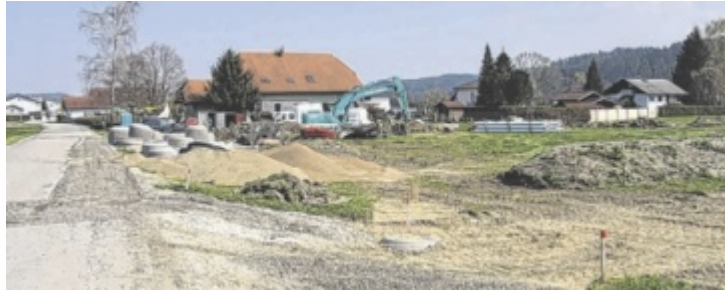
Die Versorgung der Gemeinden erfolgt über unterirdische Leitungssysteme. Im Verborgenen werden hier komplexe Netze betrieben. Foto: Gemeinde Gampern
