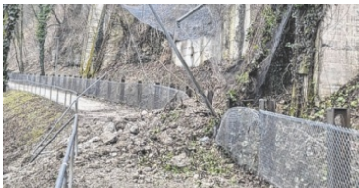
Nach dem Steinschlag bei der Lauberleite droht eine längere Sperre. Foto: Thomas Jakob
