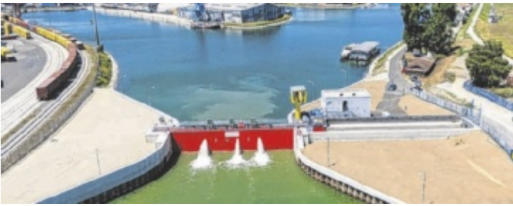
Das 26 Meter breite Hochwasserschutztor im „Safe Port of Linz“. Foto: LINZ AG/fotokersch
