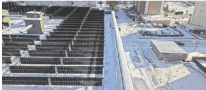
Das zukunftsweisende Projekt der EEG St. Florian nutzt bifaziale Module für effiziente Energieerzeugung.
