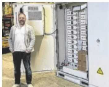
Christian Obermayr mit einem PV-Großspeicher
