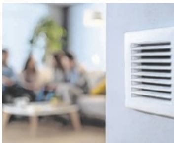
Wohnraumlüftung Foto: stock.adobe/elimice
