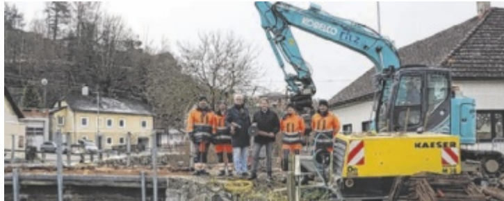
Bgm. Christian Gratzl und Infrastrukturstadtrat Rainer Widmann machten sich vor Ort ein Bild von den laufenden Abrissarbeiten.
