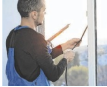
Fenster kann man auch sanieren statt sie ganz zu tauschen. Foto: Fensterdicht
