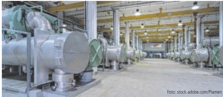
Die zentralen Anlagen sind effizient und nutzen teilweise Abwärme. (Beispielfoto)
