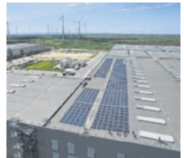
Photovoltaik-Anlage am XXXLutz Zentrallager.
