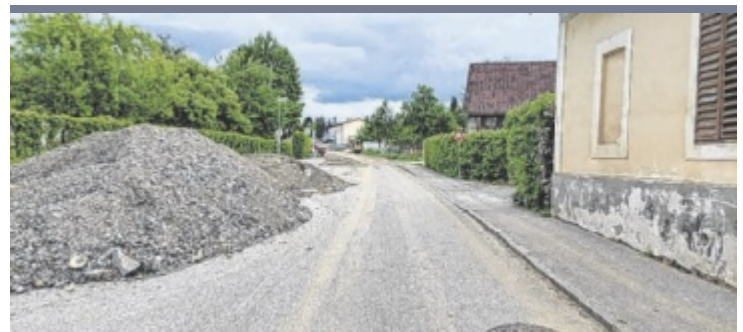
Verzögerung Wegen Grabungsarbeiten für einen neuen Kanal ist die Steiner Straße von Hausnummer 9 bis zur Kreuzung mit der Feldstraße seit 18. März gesperrt. Die Arbeiten dauern länger als geplant, voraussichtlich bis 24. Mai. Foto: rh
