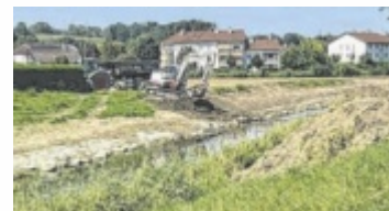
Im Bereich des Sportplatzes soll die Krems tiefer werden. Foto: Gemeinde Wartberg
