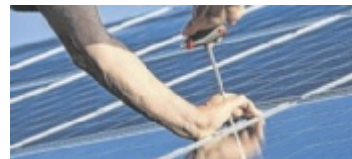
Die PV am Dach liefert den Strom fürs (Holz)haus Foto: Marina Lohrbach/stock.adobe.com
