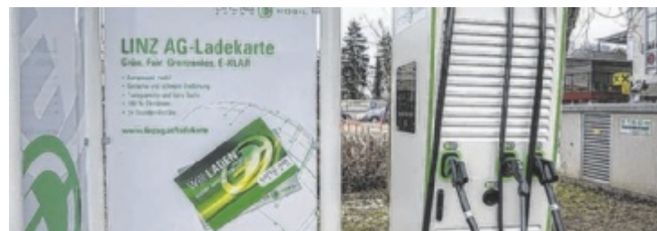
Eine Schnellladestation der Linz AG in Puchenu
